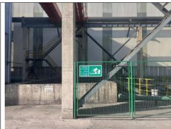
浊环水处理系统污泥暂存池
